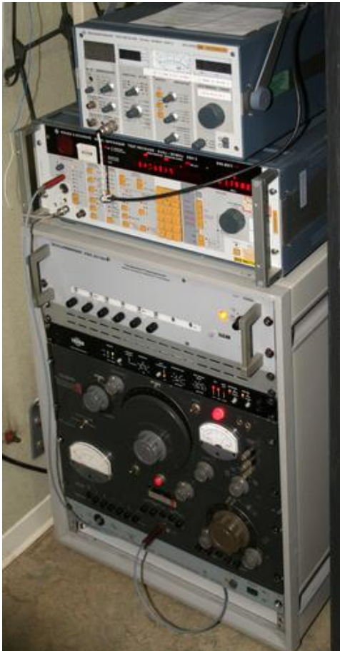
Op het rack naast de zender staan twee generaties veldsterkte meter. De oudere generatie, met buizen uitgerust staat elders in de AM demonstratie.
